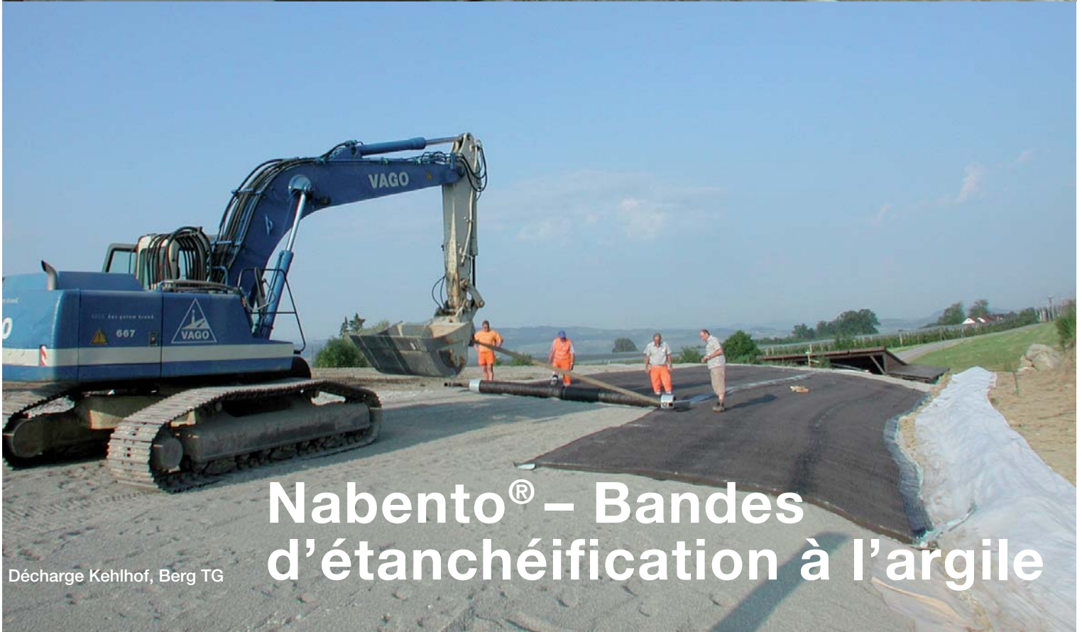
Bassin de rétention et de filtrage,, Emmen
