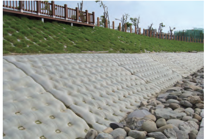
Nach der Fertigstellung (im unteren Bereich der Böschung Incomat® FP , im oberen Bereich der Böschung Incomat® Crib ) (2)
