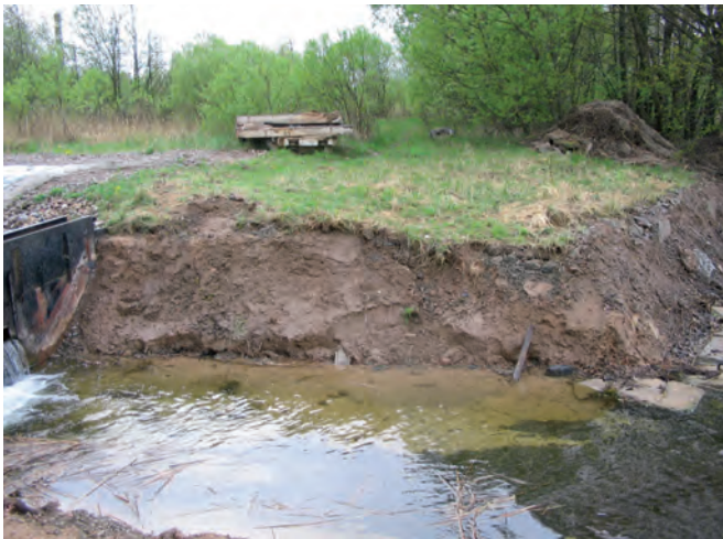
Erosionsprobleme an einem Auslassbauwerk (1)
