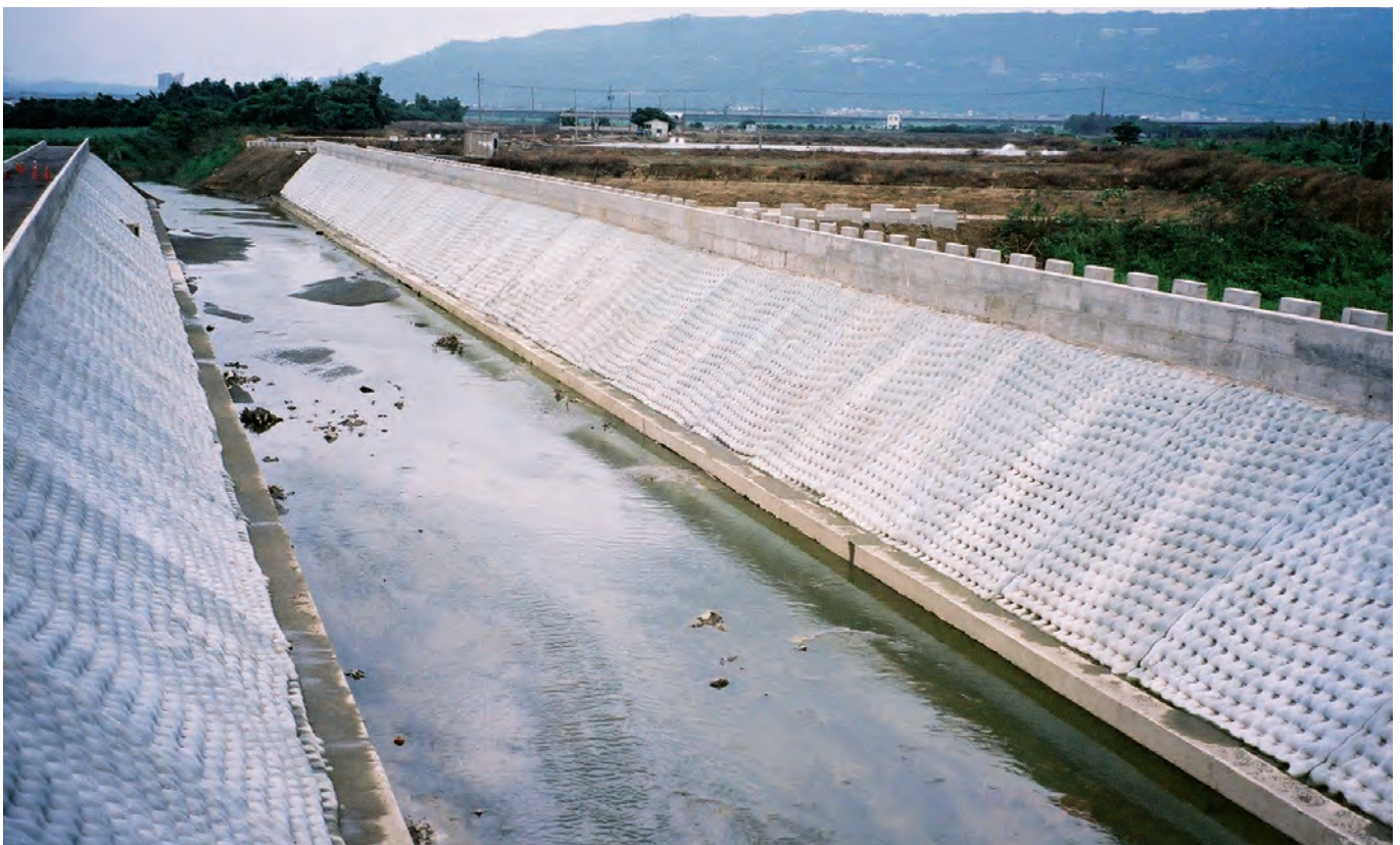
Mit Incomat® FP ausgekleideter Entwässerungskanal
