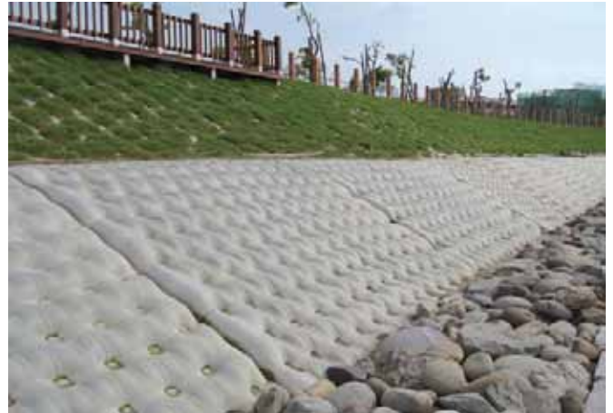
Après achèvement du chantier (Incomat® FP dans la partie inférieure du talus, Incomat® Crib dans la partie supérieure du talus)
