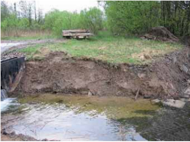
Problèmes d'érosion sur un ouvrage de déversement (1)
