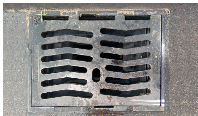
SCHOELLKOPF® FILTERELEMENT eingebaut
