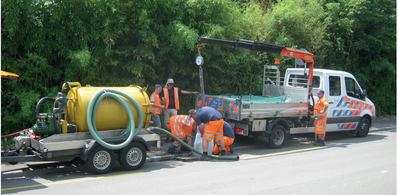
Bestückung eines Schlammsammlers mit einem SCHOELLKOPF® FILTERELEMENT im Rahmen des Monitorings an der Seestrasse in Männedorf
