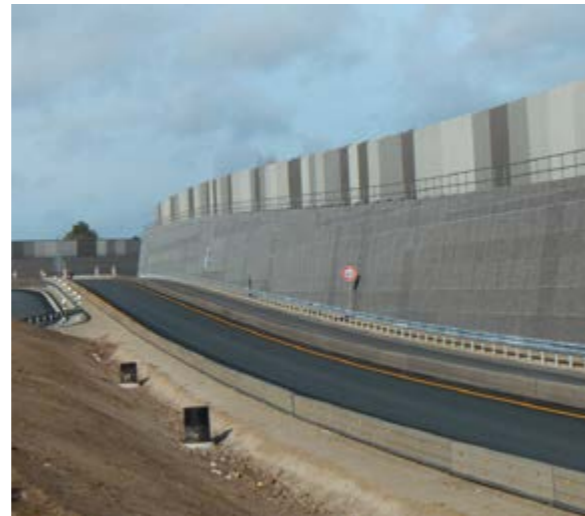
Hochabsorbierende Lärmschutzwand Deutschland | Bau einer hochabsorbierenden Lärmschutzwand beim 6-spurigen Ausbau der A3/A73, Fürth-Erlangen – Absorptionsgruppe A 3 (Schallabsorption DL_a \geq 8 - 11 dB) – Gabionen zur Fahrbahn und Begrünung zur anderen Seite – Höhe bis zu 10 m.
